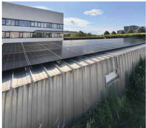
Abbildung 5: Die 2024 installierte Photovoltaikanlage auf den Dächern der CVUA-Garage
